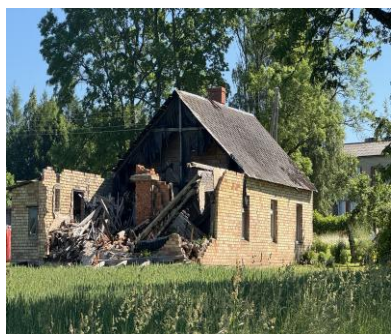
Ēkas fasāde./dzīvokļa izvietojums sabrukušajā daļā.
